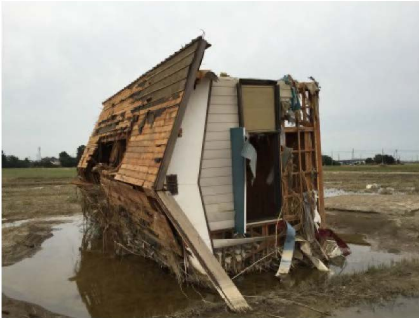
写真6 転倒した住宅Cの2階部分
